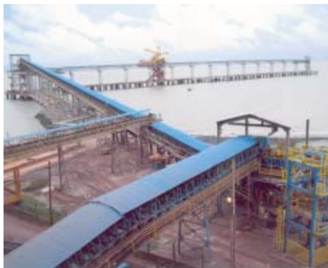
▲ Carregador de minério com capacidade de transportar 8.000 tons./hora.
