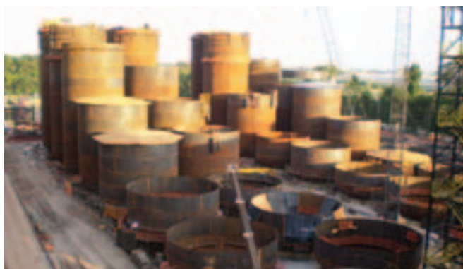
▲ Montagem dos precipitadores que integram a terceira expansão da Alunorte.
