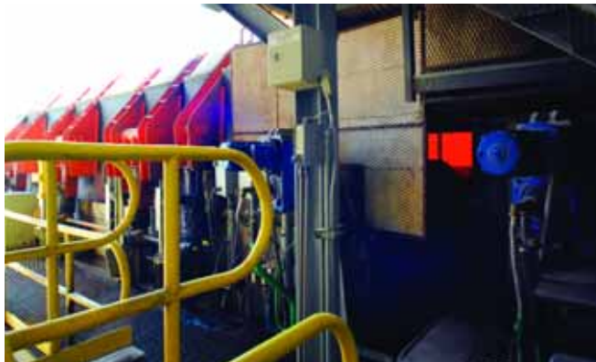
▲ 780 mil toneladas de tubos de acero sin costura serán tratadas en estas nuevas instalaciones.
